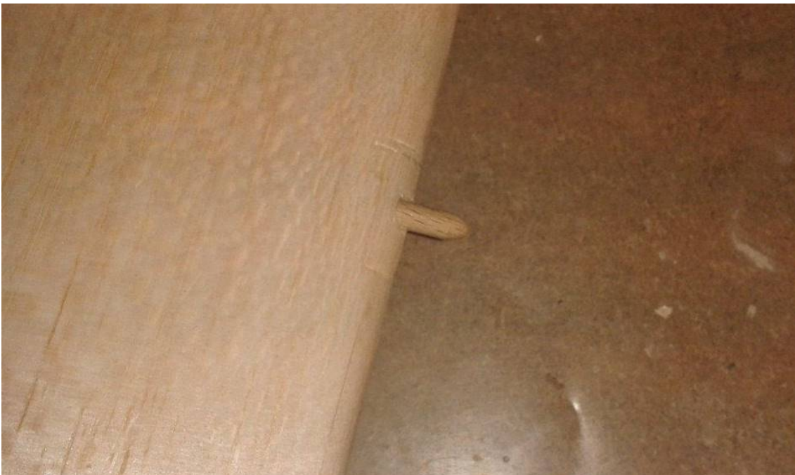
Eingeklebter Befestigungsdübel der Fläche
